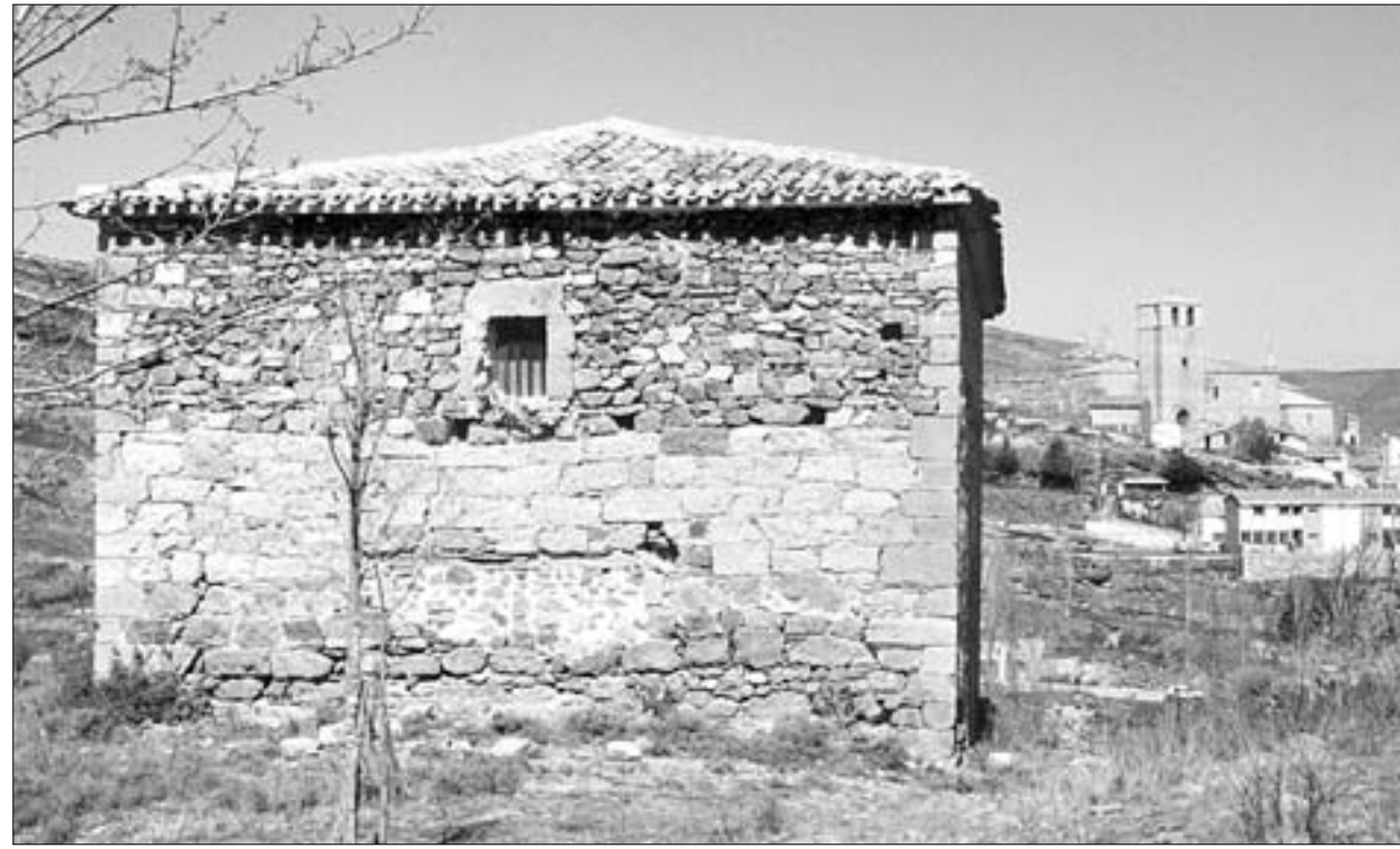
Fachada oeste de la ermita de la Virgen del Campo con la iglesia de N o S a de la Estrella y las ruinas del castillo, al fondo
